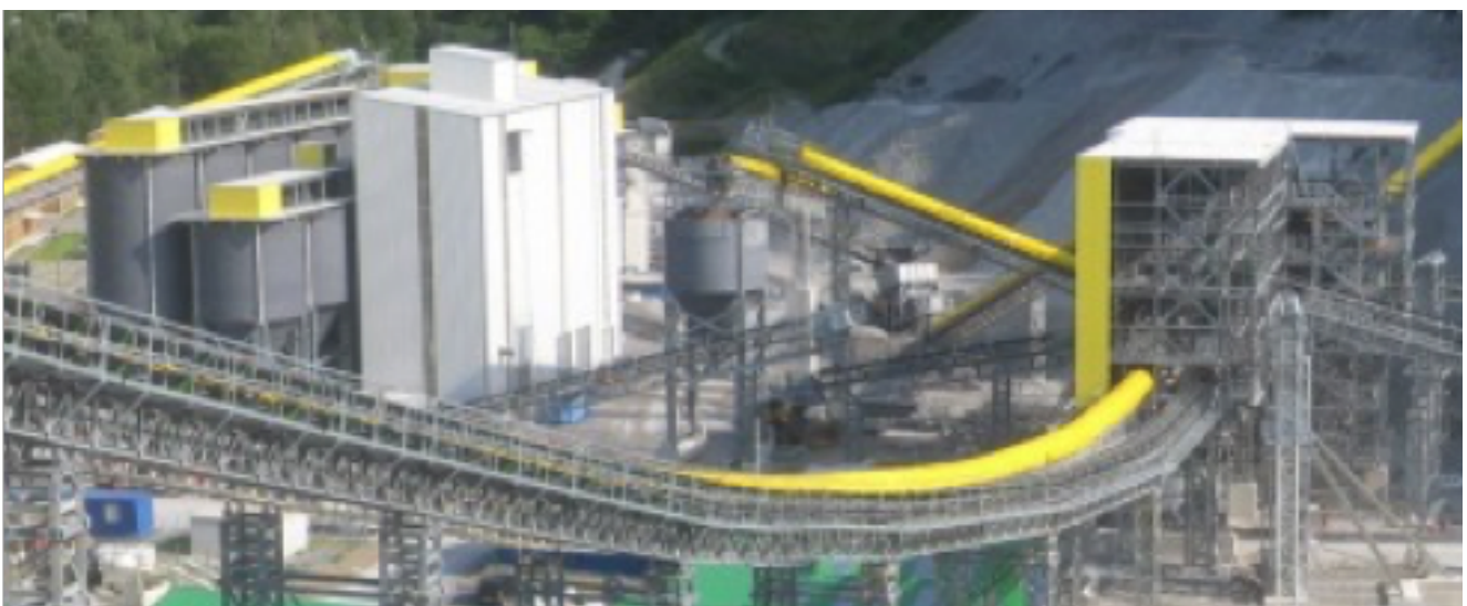
Impianti GM a Sigirino: torre di trasbordo (destra), impianto di lavorazione inerti (sinistra), nastri a deposito definitivo (primo piano)
