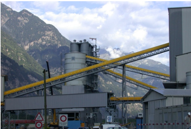
Impianti Gestione materiale e centrale beton
