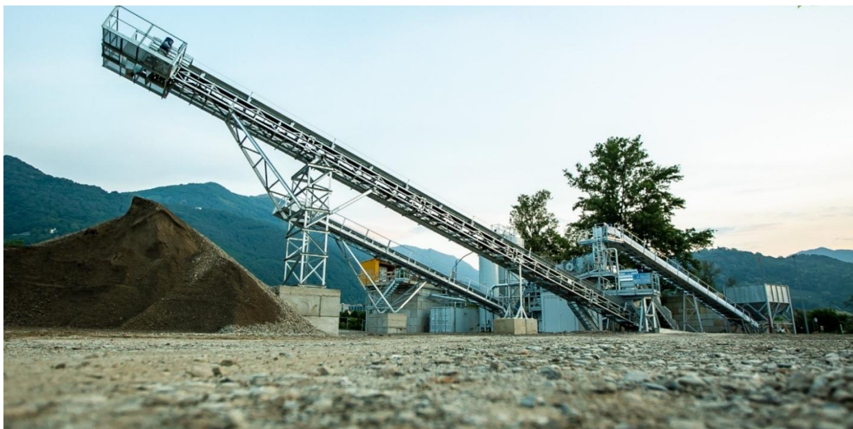
Impianto fisso per selezione, lavaggio e produzione di misti granulari certificati
